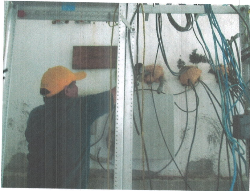
Ing. Alberto González López, durante instalación de cableado al interior de la infraestructura de Protección Civil del Estado.
