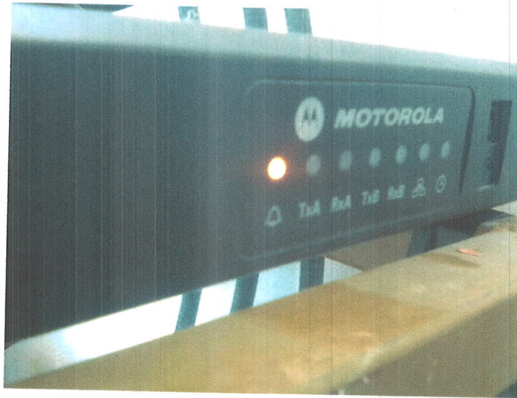
Repetidor mostrando ingreso de energía, dentro de los parámetros normales.
