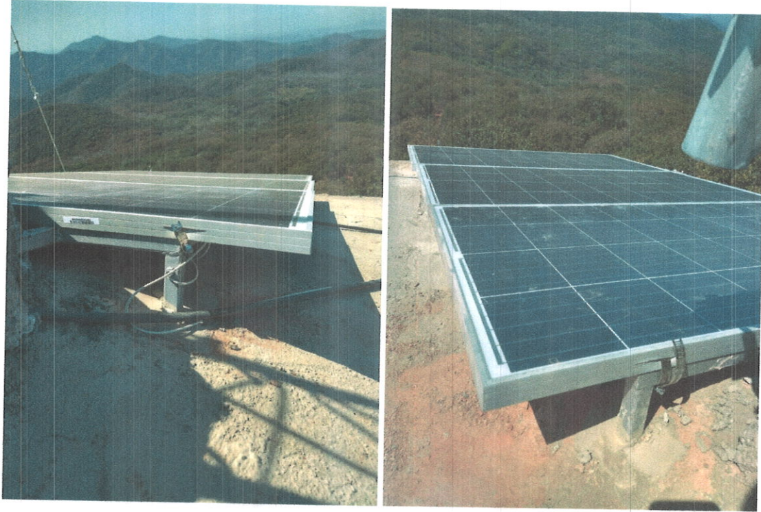
Paneles solares instalados.
