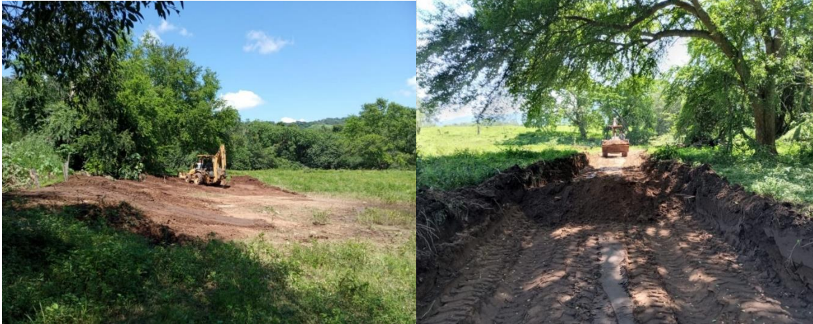
Actividades de construcción de berma y dren para mitigar afectaciones al Humedal de San Miguel
