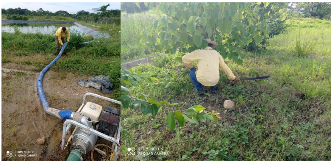
Integrantes de brigada regional JICOSUR 1 durante tareas en relleno subregional de Villa Purificación.
