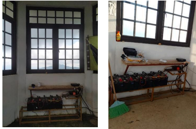
Ilustración 10: Antes y después de mantenimientos a torre Potrero Grande (se observa la batería de ciclo profundo extra en la serie)
